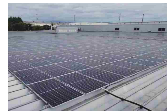
本社屋上の太陽光パネル
