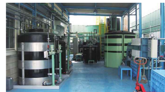
大型排水処理装置
