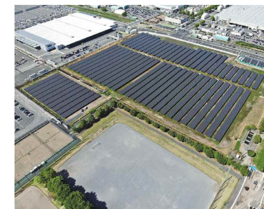
大泉工場:太陽光発電設備
