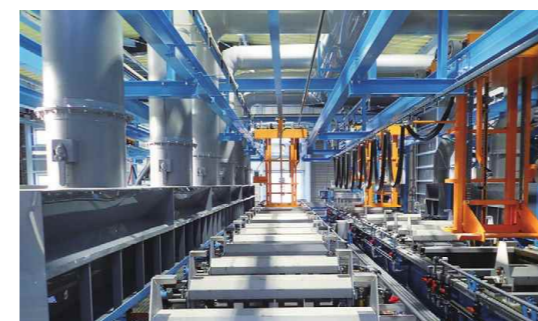
ライン設備のスクラバーダクト
