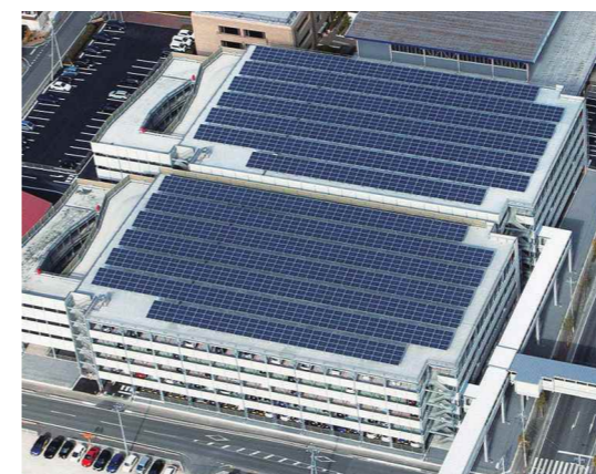
矢島工場:立体駐車場の太陽光発電設備
