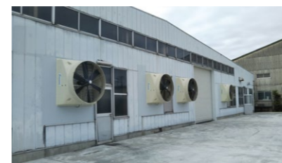
工場に導入した大型換気設備
