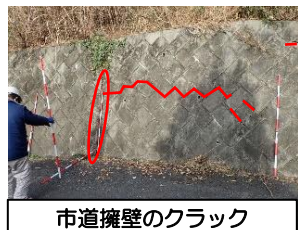
市道擁壁のクラック
