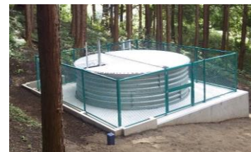
R6実施箇所の集水井
