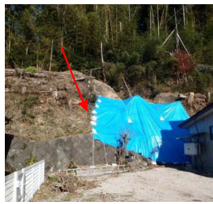
がけ崩れ状況 (H29年10月)
