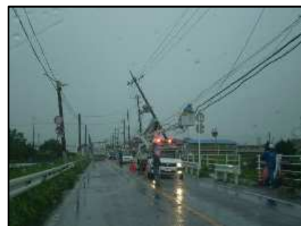
＜災害時の電柱倒壊状況＞ （国道 354 号）
