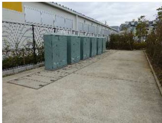
江戸川区（公園用地への設置事例）
