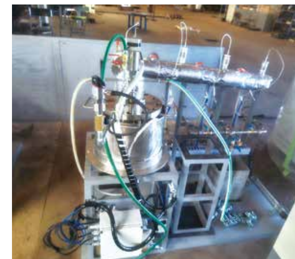
加圧水熱分解処理装置
