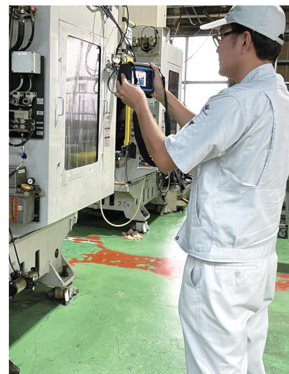
エアー漏れ調査
