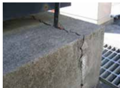
看板基礎のひび割れ
