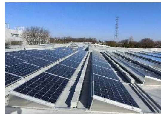
太陽光発電設備
