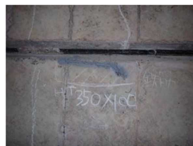
写真③ 鉄筋露出
