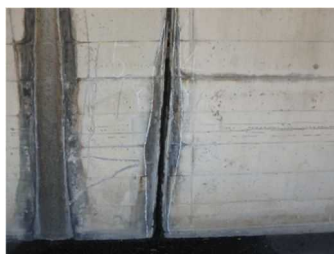
遊離石灰の発生
