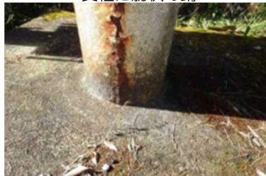
支柱に筋状の錆
