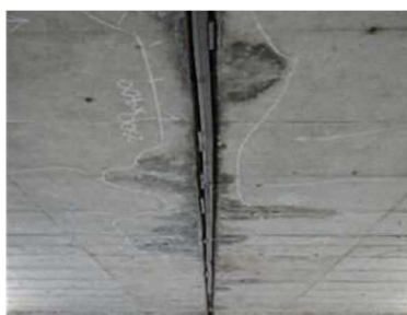
写真② 目地の漏水
