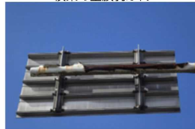
横梁の塗膜剥がれ
