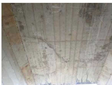
写真① コンクリートひび割れ
