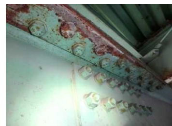
ボルトの腐食
