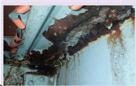
橋梁における床版腐食の例
