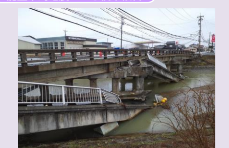
能登半島地震による橋梁被害
