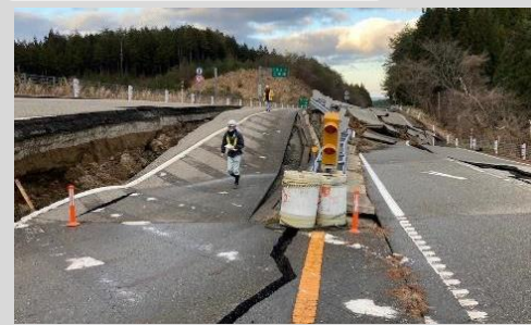
能登半島地震による被害状況
