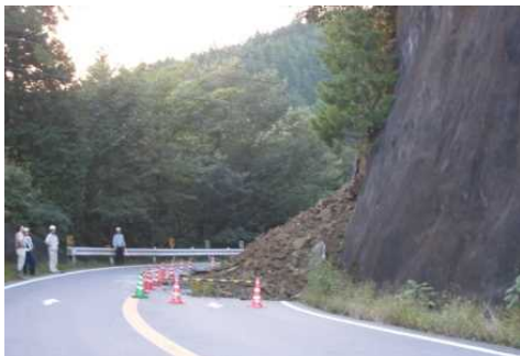
国道145号斜面崩壊
