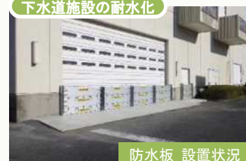
防水板 設置状況
