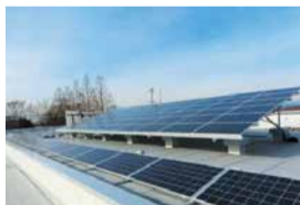
太陽光発電設備
