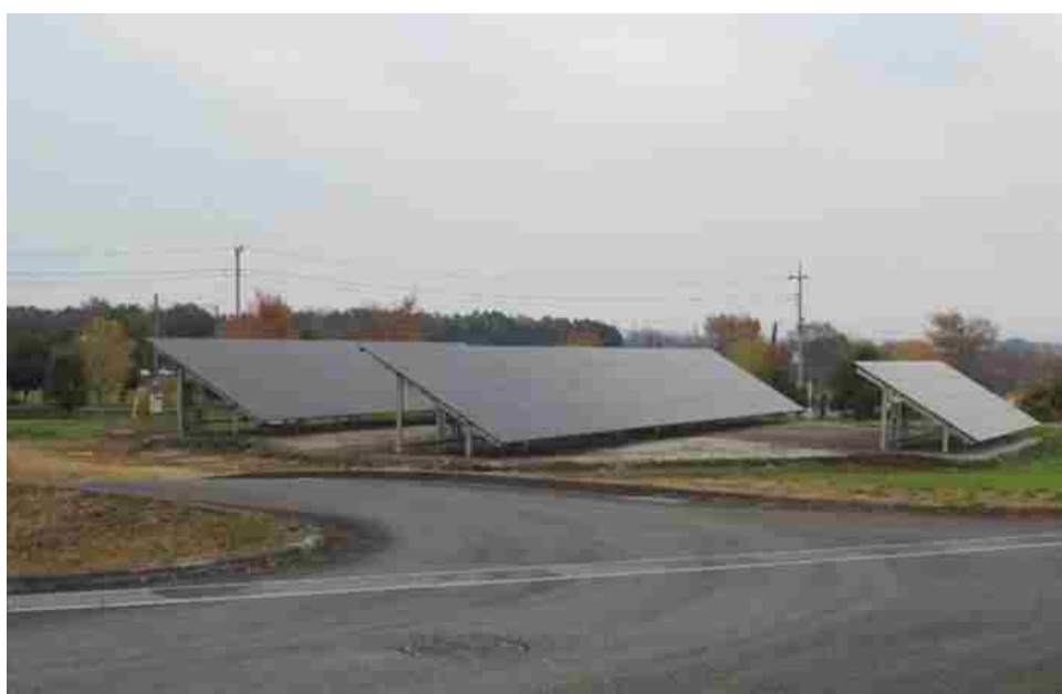
【図1-9 西邑楽太陽光発電設備の設置状況】
