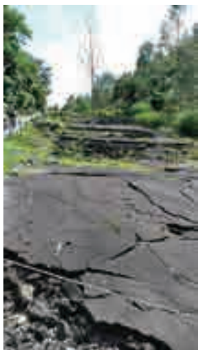
隆起してしまった国道
