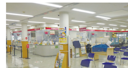
照明器具のLED化
