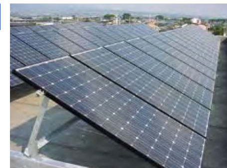
本社屋上に設置された太陽光パネル
