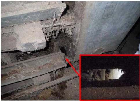
除糞ベルトの隙間・穴
