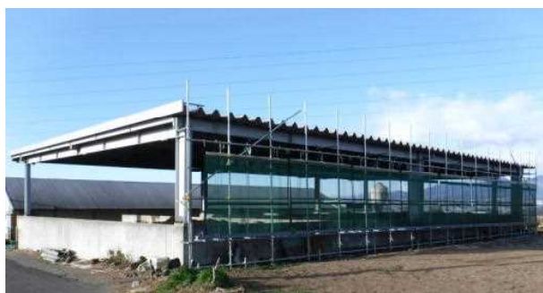
写真 養豚農家堆肥舎における設置状況
