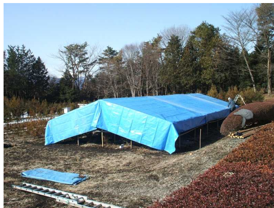
図-4 簡易防除施設設置状況
