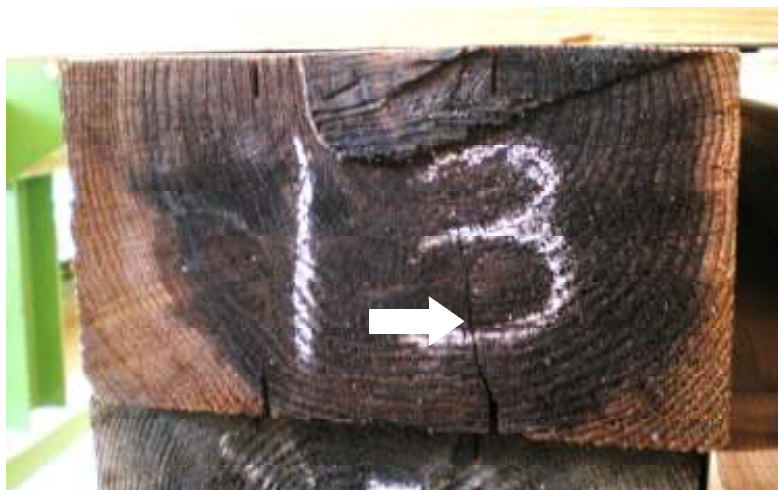
図- 16 スリット底部から材中心に向かって発生した割れ
