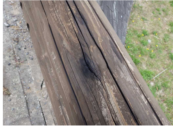
図-13 左から2年経過後の劣化状況（被害度2）
