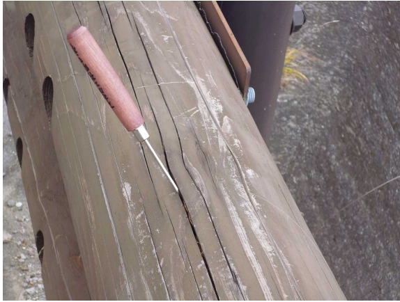
図-12 4年経過時の劣化状況（原町、被害度1）
