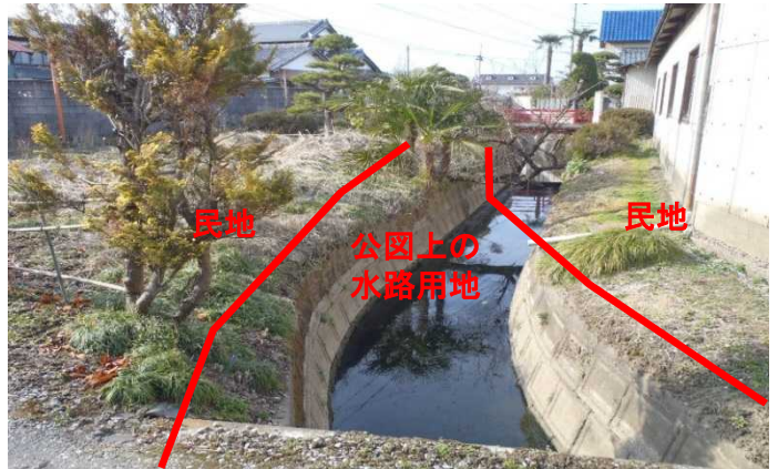
公図上と現地が相違している状況
