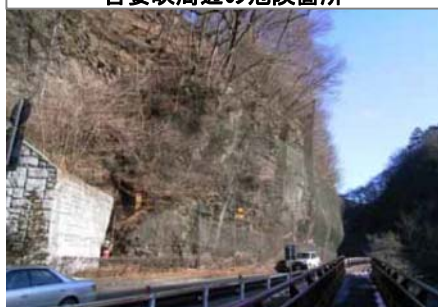
吾妻峡周辺の危険箇所
