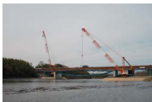
国道354号玉村伊勢崎バイパス工事状況 (平成26年度東毛広幹道が全線供用予定)
