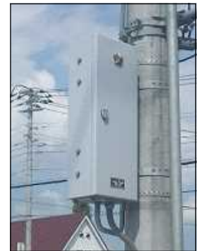
【信号機電源付加装置の整備】
