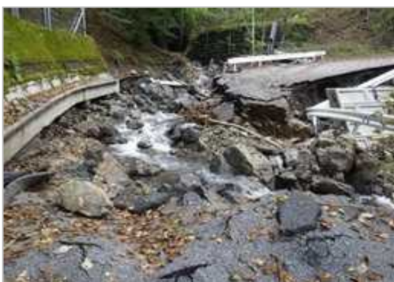
台風19号による被災状況
