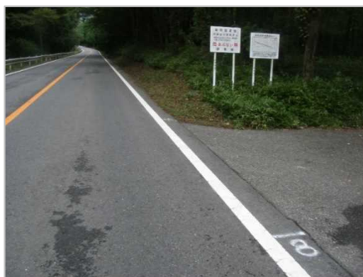
道路の除草状況（前橋赤城線）
