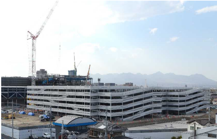
△敷地南東側からの立体駐車場の外観（奥は会議・展示施設）
