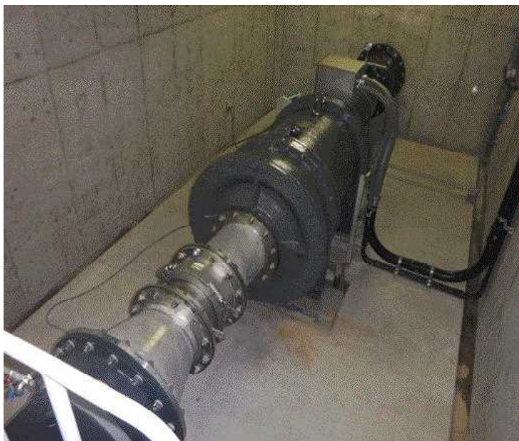
小坂子発電所内部
