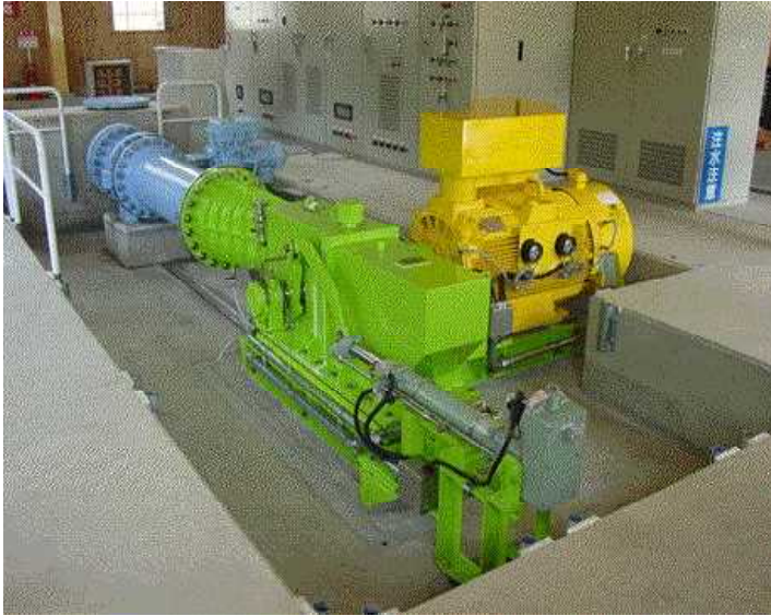
東第二発電所内部
