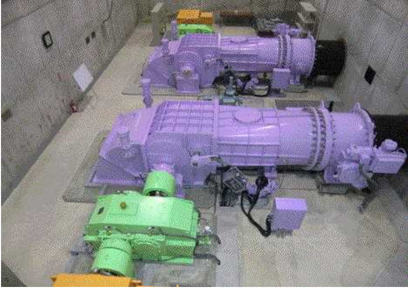
新利南発電所内部
