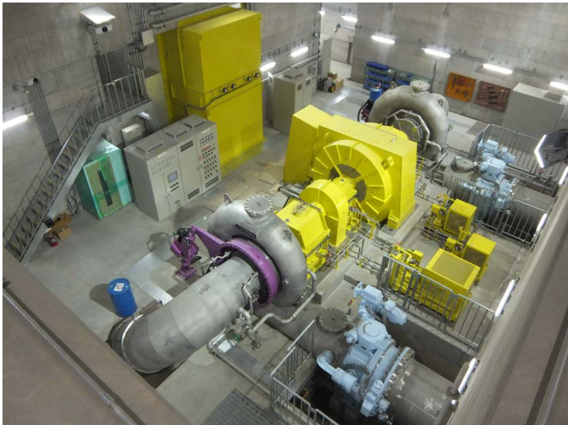
八ッ場発電所 水車発電機
