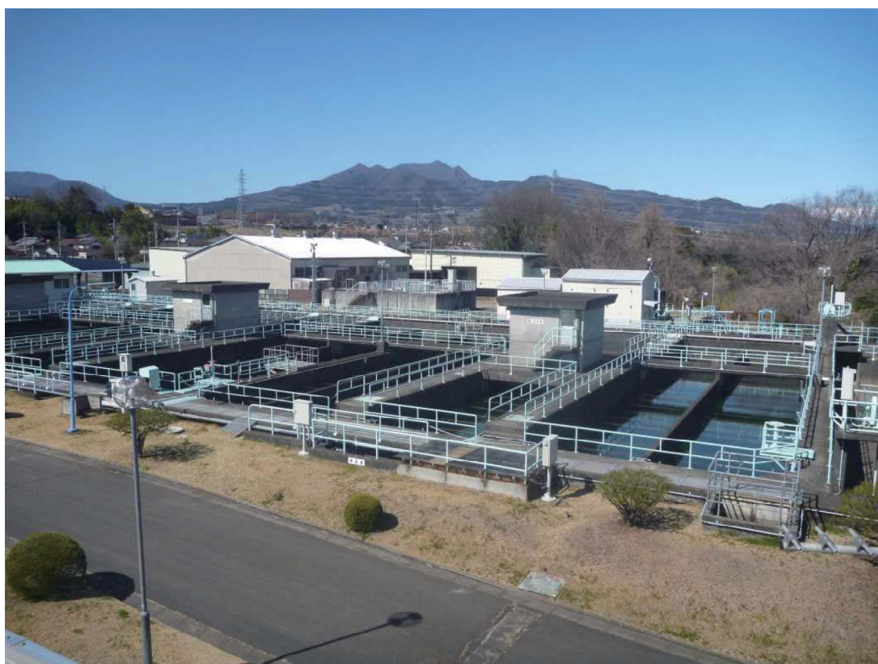
渋川工業用水道事務所 沈澱池
