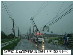
竜巻による電柱倒壊事例（国道354号）
