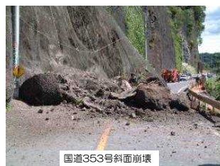
国道353号斜面崩壊
