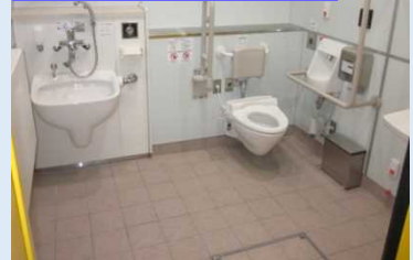
高齢者・障害者等対応トイレ
