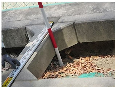
法枠工中詰材流出
