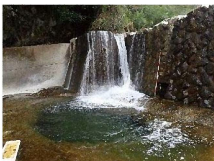
堰堤基礎部洗掘
