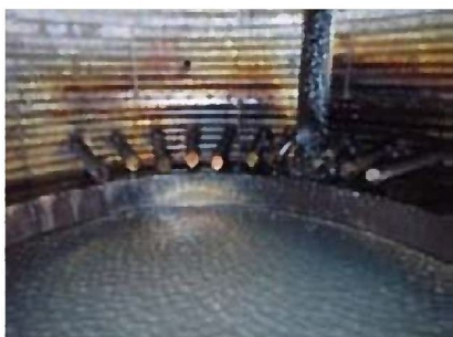
集水井内の集水管目詰まり
