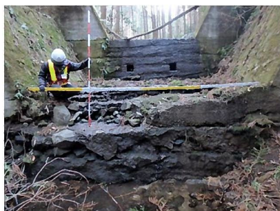
垂直壁摩耗欠損
