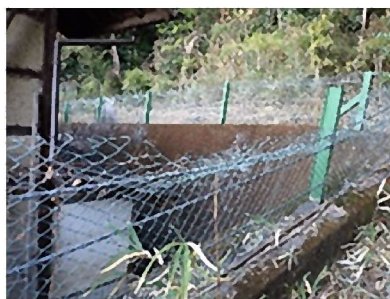
待受防護柵ネット損傷
