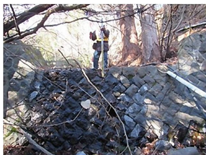
水通し部石積欠損
