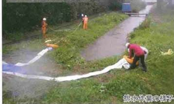
排水ポンプ車全景
