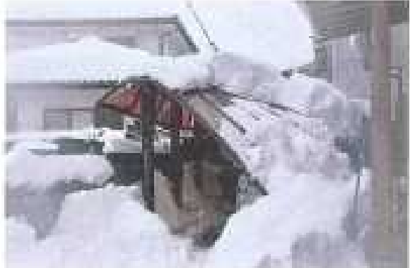
■平成26年2月降雪による被害
