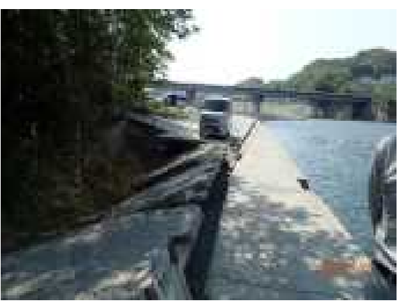
⑥ 吉井町池 多胡橋下流右岸 被災後写真
