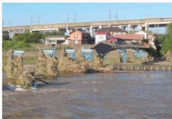
台風により被災し流出した佐野橋
