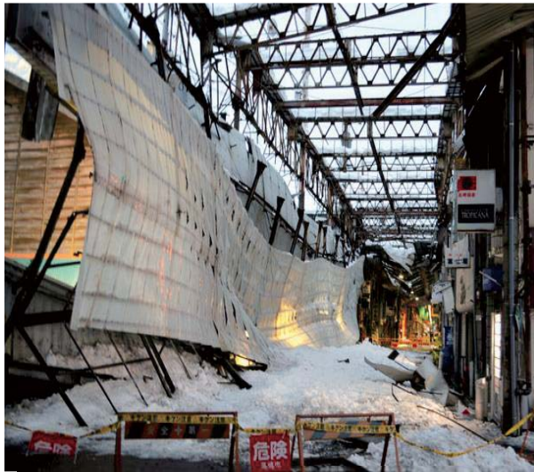
平成26年2月 高崎中央銀座商店街アーケード崩落
