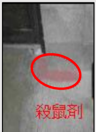
ネズミの侵入跡、 粘着シートの確認
