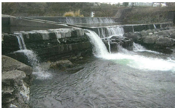
写真3 移動障害のある取水堰
