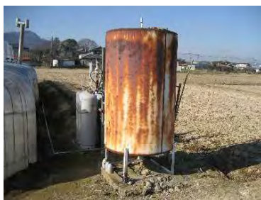
× 燃料漏れの危険性が高いタンク
