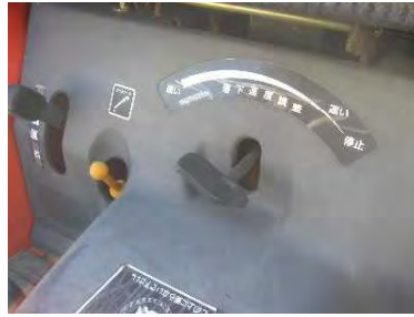
○ 昇降部落下防止装置の確認
