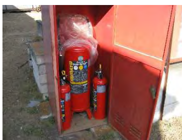
○ 消火器の設置
