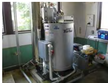
ボイラーもメンテナンスが重要
