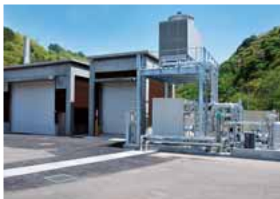
写真：木質バイオマス発電施設
