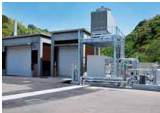
写真：木質バイオマス発電施設
