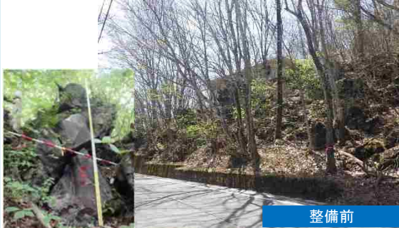
斜面上の転石、浮石
