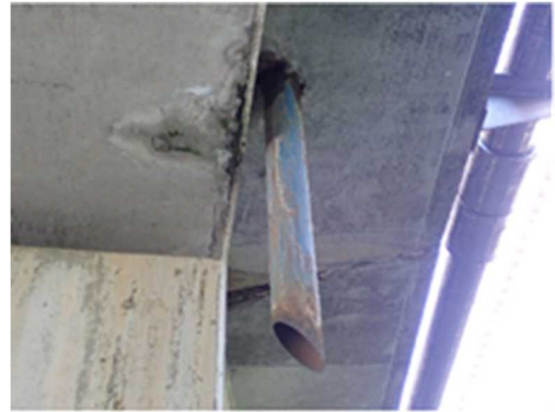
H30前橋土木事務所定期点検 神沢橋 部材対策区分判定B
