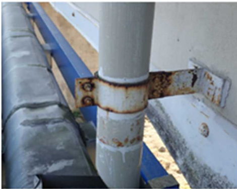
H30前橋土木事務所定期点検 赤城大橋 部材対策区分判定A
