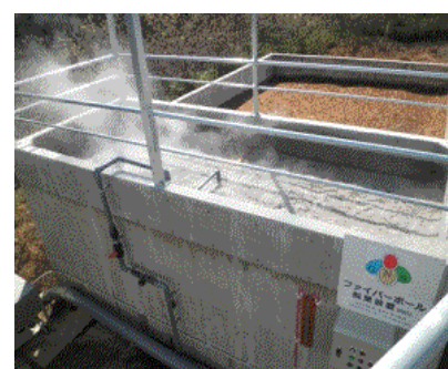
密閉型堆肥化装置に設置
