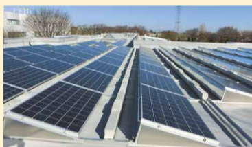
太陽光パネル
